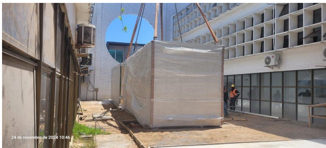
Legenda: Entrega Data center Prédio Fórum Clóvis Bevilacqua Fonte: Arquivo Próprio
